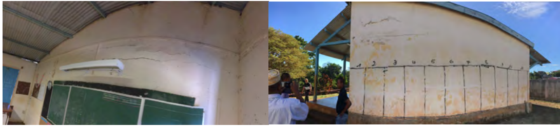
Fig. 40 – Ecole de Barkani 2, dommages de degré 2, vulnérabilité A (nombreuses fissures, ici fissure traversante dans mur en maçonnerie). (Photo CS/BCSF)
