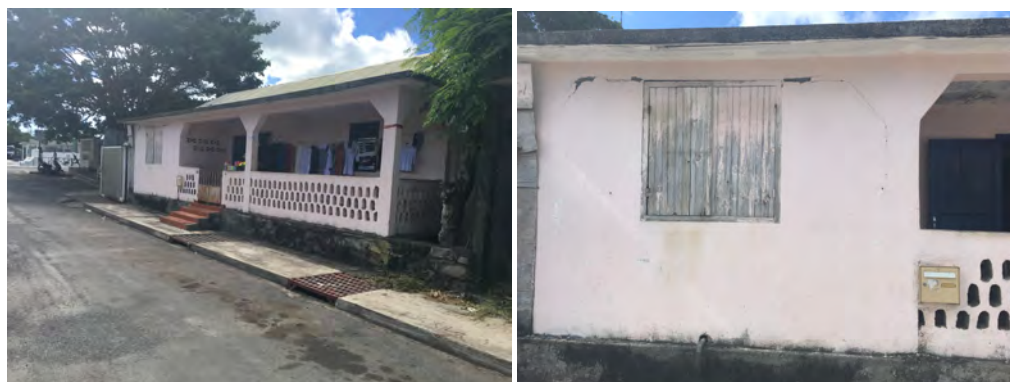
Fig. 41 : secteur ouest de Pamandzi, en bord de mer, ossature béton armée et remplissage en maçonnerie majoritairement construites avec du sable de mer favorisant la corrosion des aciers. Fissures aux liaisons ossature et remplissage. Les dégâts sont principalement de degré 1 à 2 pour une vulnérabilité A. (photos-AS-BCSF).
