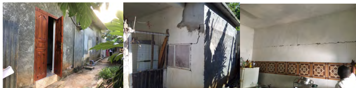
Fig. 20 – Quartier Poroani, Maison ossature béton et maçonnerie de parpaings, dommage de degré 2 (photos-CS/BCSF& ER/OPGC).
