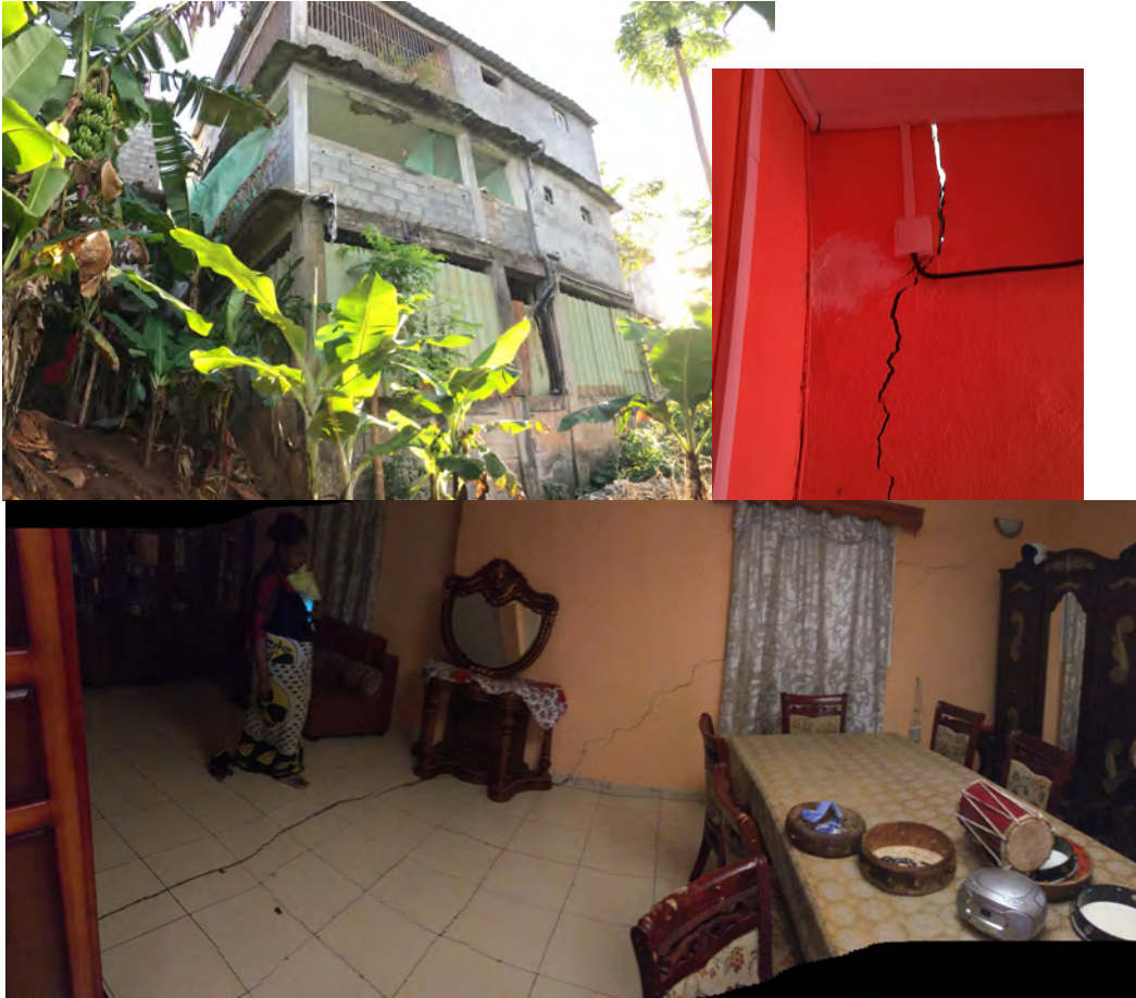
Fig. 47 – Maison en ossature béton armé et parpaings, RC+2 sur terrain en pente, préalablement endommagée, dommages de degré 3 (vulnérabilité A). La partie arrière vers la pente se détache du reste du bâtiment. La partie avant (RC sur la rue) est extrêmement fissurée (fissuration larges murs, planchers, ossature). (Photo CS/BCSF)
