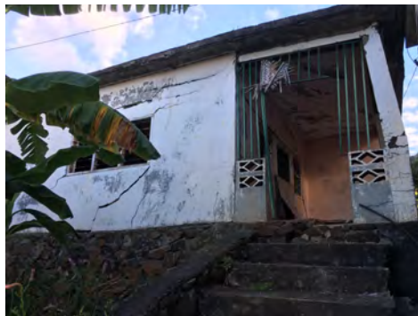
Fig. 35 – Quartier Fouboudi, dommages de degré 3 préalable aux séismes, construction de vulnérabilité B – (Photo CS/BCSF).
