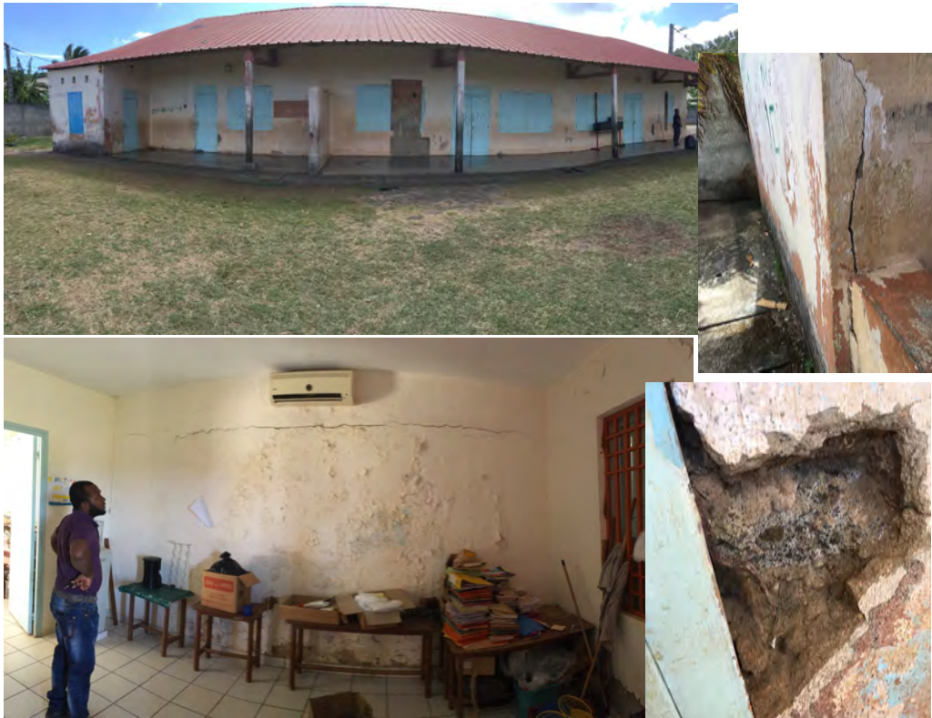
Fig. 38 – Ecole primaire n°1, vulnérabilité A, maçonnerie de pierres (endommagement préalable), dommages de degré 2 (fissuration, murs, plafonds). (Photo CS/BCSF)
