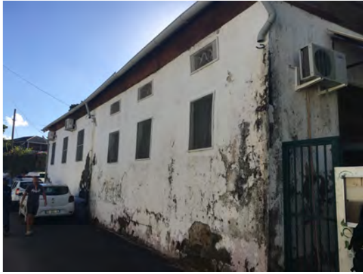
Fig. 25 : Ecole élémentaire « Les Colibris » Vu extérieure montrant l'enduit vétuste avec nombreuses fissures mais dont leur extension dans les murs reste spéculative. (photo-AS-BCSF).
