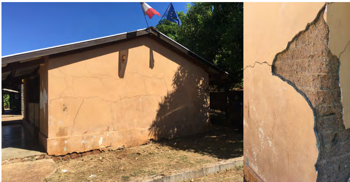
Fig. 28 : Poste de Police, en maçonnerie friable avec épais enduit très fortement fissuré et des parties détachées. La prolongation des fissures dans les murs n'est pas visible. Dégâts de degré 1 à 2 et classe de vulnérabilité A. (photos-AS-BCSF).
