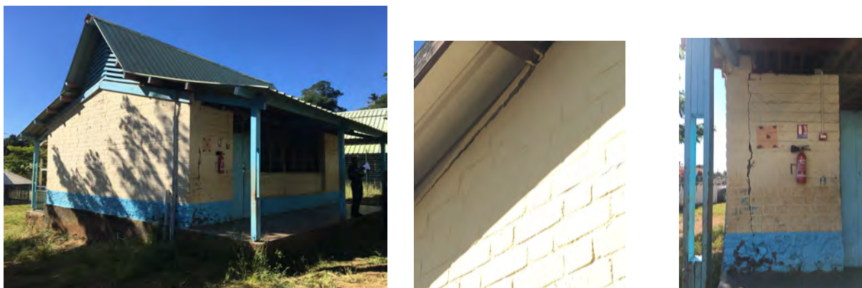
Fig. 12 : Collège de Bandré (type case SIM) avec fissure à la jonction des murs et décalage de la charpente en bois / murs. Dégâts degré 2 pour une classe de vulnérabilité A. (photos-AS-BCSF).
