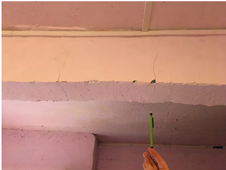
Fig. 10 : Plusieurs fissures fines traversantes sur une poutre d'une maison en zone de mangrove (degré 2 sur ossature béton armé et remplissage en maçonnerie, vulnérabilité estimée B) (photo-AS-BCSF).
