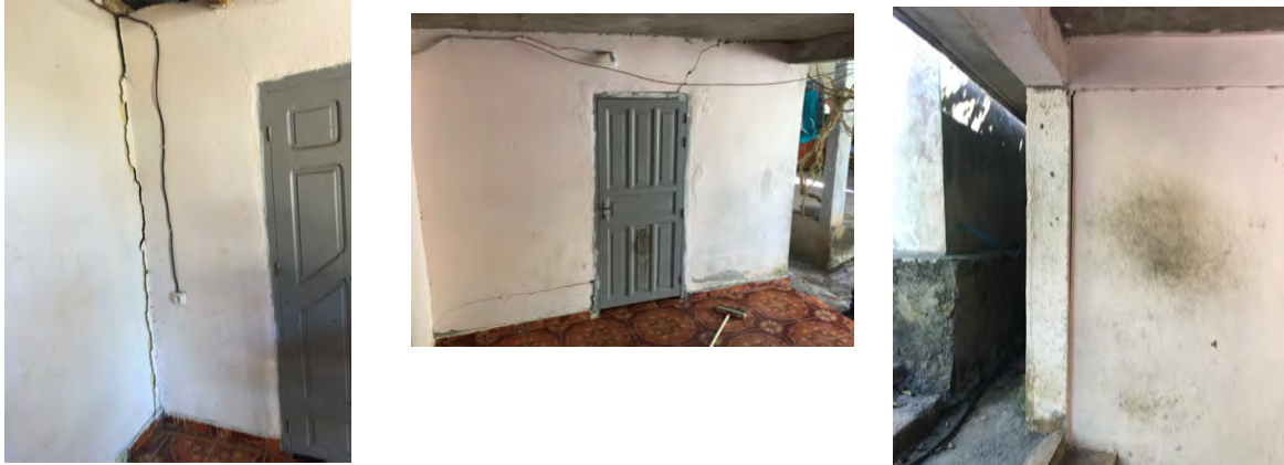
Fig. 14 : Maison ossature béton armée et remplissage en maçonnerie, avec de nombreuses fissures dans la maçonnerie, à la jonction maçonnerie/ossature et dans les liaisons poteaux-poutres. Dégâts de degré 2 pour une vulnérabilité B. (photos-AS-BCSF).
