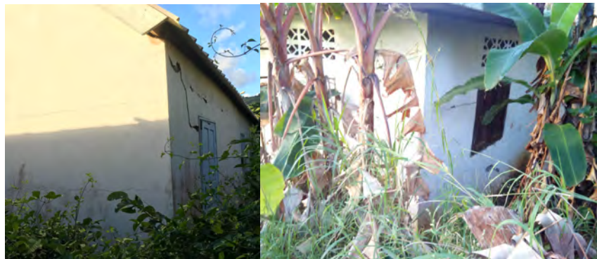
Fig. 34 – Exemples de dommages de degré 2 sur des maisons de maçonnerie (vulnérabilité A ou B) quartier de Fouboudi. (Photo CS/BCSF)
