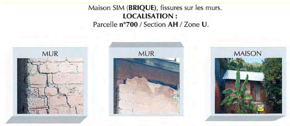
Figure 33 : Rapport de police de la commune de Mtsamboro, dommage de degré 3 sur un bâtiment de briques crues en argile compressée.
