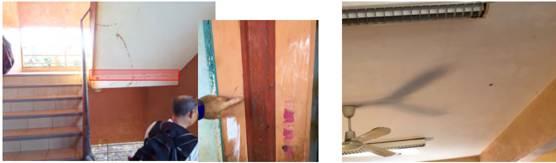
Fig. 18 – Ecole primaire Matsabouri, fissure dalle d’escalier, mouvement différentiel entre les corps de bâtiments, nombreuses fissures fines au plafond (photo-ER-OPGC).
