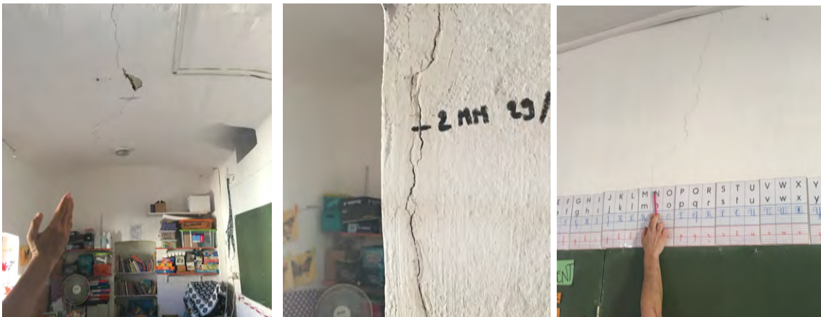
Fig. 26 : Ecole élémentaire « Les Colibris » en maçonnerie: Gauche : voûte avec affaissement central. Centre: exemple d'une fissure de 2mm observée le 29 mai. Droite. Exemple de fissure fine dans un mur. Dégâts degré 2 pour une vulnérabilité B. (photos-AS-BCSF).
