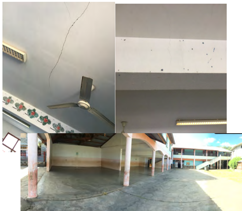
Fig. 37 – Ecole maternelle Centre, dommages de degré 2 (fissuration fine, murs, plafonds et poutres). (Photo CS/BCSF)
