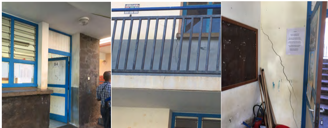
Fig. 31. Ecole Mamoudzou quartier M'Gombani vulnérabilité B, dommages de degré 2 (photos-CS/BCSF).
