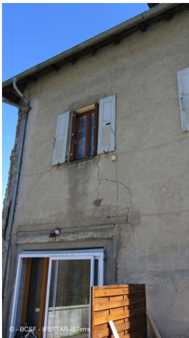
Photo J2 - Dommages de degré 2 Maçonnerie en pierres brutes – dégât structural léger.
