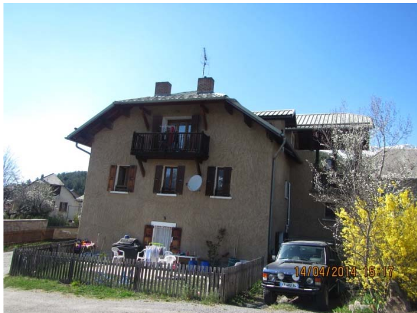
Photo SP01 - cheminée de gauche: déplacement du chapeau de cheminée, enlevé après le choc.
