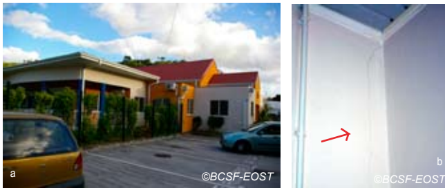
Fig. V-103 : Le Carbet, crèche comportant quelques microfissures, vulnérabilité D-E (terrain plat et mou).
