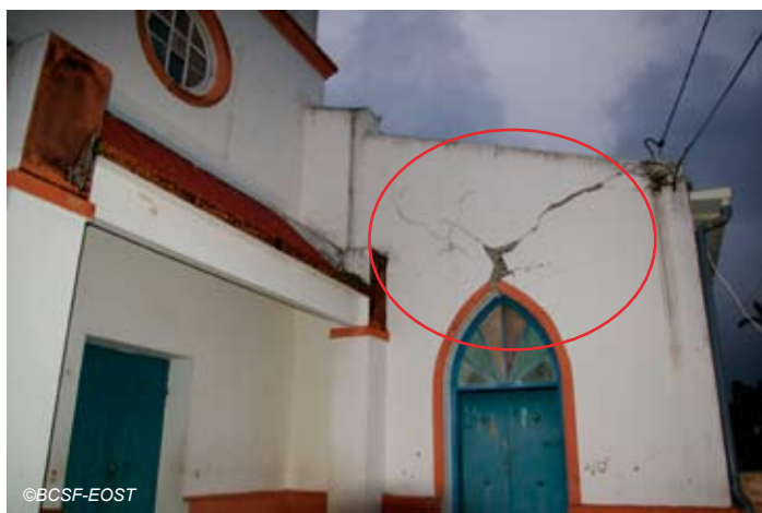
Fig. V-58 : Sainte-Marie, église Morne des Esses, fissure large et traversante (mur en moellons).
