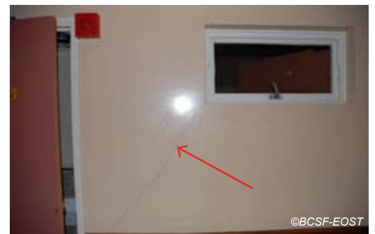
Fig. V-83 : La Trinité - (CH L.D), fissure fine à 45° en angle de fenêtre sur cloison.
