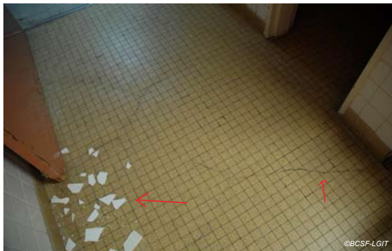
Fig. V-87 : La Trinité - (CH L.D), chute de morceaux de carrelage mural et fissures au sol.
