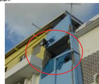
Fig. V-198 : Le Marin - Capitainerie - effondrement d'un panneau préfabriqué en béton
