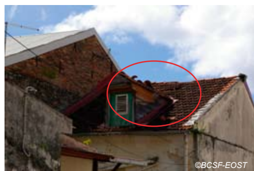
Fig. V-67 : Saint-Pierre centre - maison individuelle, chute de tuiles.
