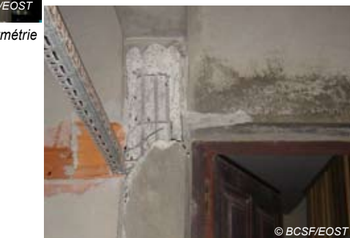
Fig. V-212 : Le Marin - maison individuelle du quartier Huvet. endommagement d'un pilier.
