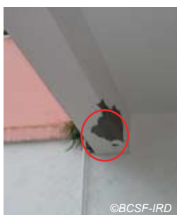
Fig. V-97 : Ecole de Morne Vert, dommage sur poutre porteuse.
