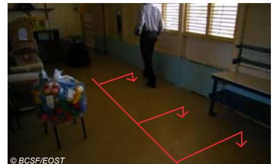
Fig. V-160 : St.-Esprit, annexe de la Maternelle 1 - affaissement et cassure de la dalle.
