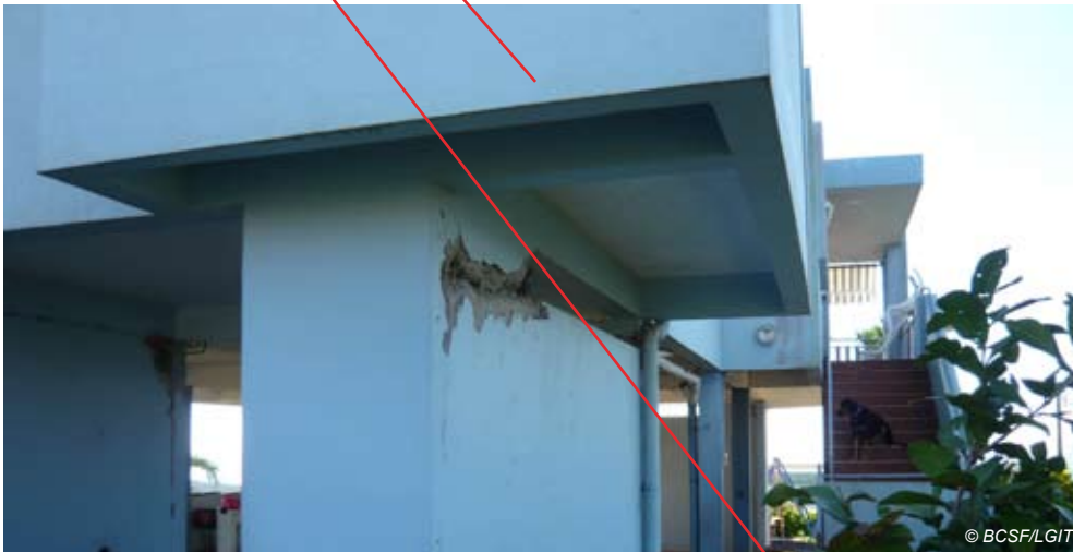
Fig. V-219 : Sainte-Luce - maison individuelle - fissuration importante dans pilier porteur.
