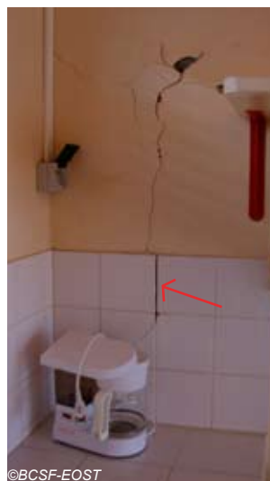
Fig. V-38 : Ecole primaire de Dominante, fissure légère et éclatement de carrelage.
