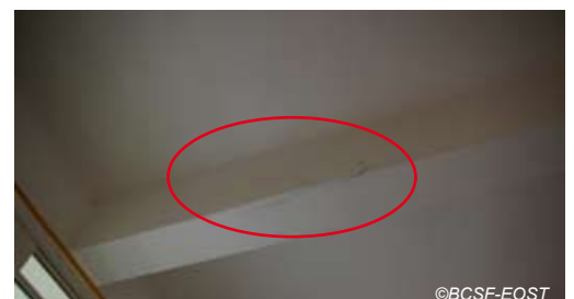
Fig. V-11 : Grand-Rivière, fissure sur poutre porteuse. (dommage structural).
