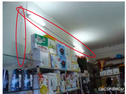
Fig. V-22 : Le Lorrain - Magasin ayant connu la chute d'objets et des fissures de niveau 2;
