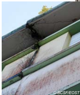
Fig. V-152 : Le François, école Morne Pitault, éclatement de béton au niveau du joint de dilatation (effet d'entrechoquement).
