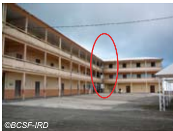
Fig. V-26 : Le Lorrain, école Léon Cécile Carabin, dégâts liés à l'entrechoquement des bâtiments;
