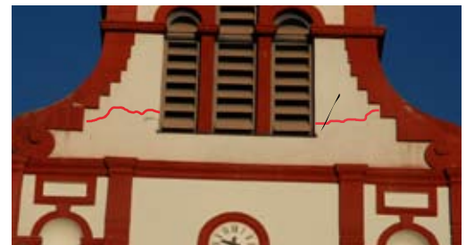
Fig. V-156 : Ducos - Fissuration du clocher de l'église.
