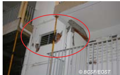
Fig. V-209 : Le Marin - maison individuelle du quartier Huvet - endommagement poteaux-poutres et fissuration dans un mur de remplissage.
