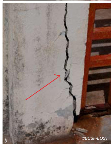
Fig. V-66 : Saint-Pierre centre - exemples de fissures observées sur quelques maisons individuelles en structure poteau/poutre et remplissage. (vulnérabilité A et B).
