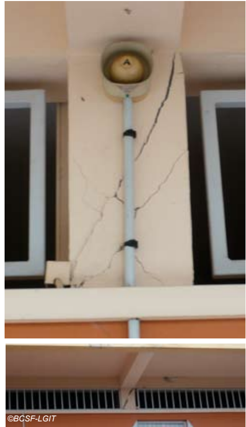
Fig. V-78 : Gros-Morne - école La Fraîcheur fissure en X, effet "poteau court".
