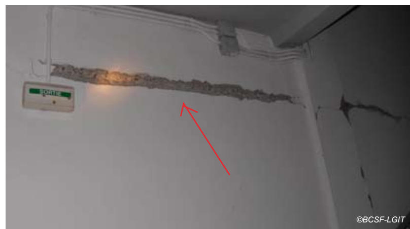
Fig. V-89 : La Trinité, bâtiment E de l'AFPA - fissure horizontale dans béton banché.
