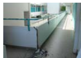
Fig. V-203 : Le Marin - Lycée Raymond Nérès, entrecroquement des garde corps, suite à l'oscillation des deux bâtiments).
