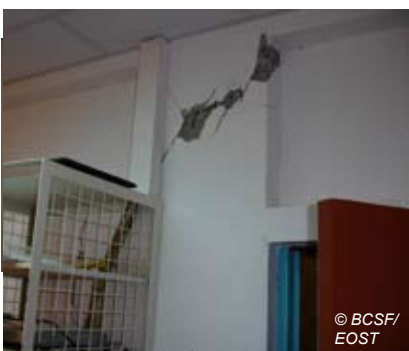
Fig. V-199 : Le Marin, presbytère, rupture d'un poteau.
