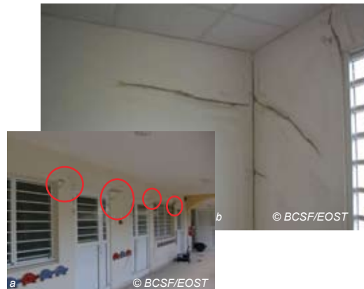
Fig. V-191 : Rivière Pilote - Ecole maternelle Manikou - fissures fines en cours de réparation (murs porteurs).
