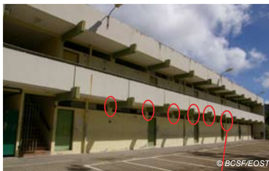
Fig. V-190 : Rivière Pilote - Collège Jacques Roumain - bâtiment D, fissures en X.
