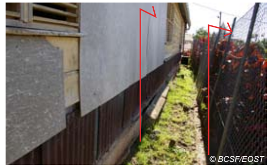
Fig. V-158 : St.-Esprit , annexe de la Maternelle 1 - affaissement en bord de talus.
