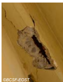
Fig. V-65 : Eclatement de béton sur élément corrodé.
