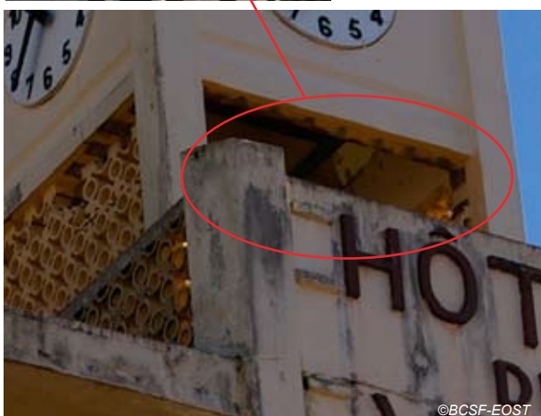
Fig. V-70 : St. Pierre - tourelle de la mairie (effondrement du claustra).
