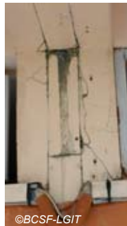
Fig. V-77 : Gros-Morne - école La Fraîcheur dégât au joint de dilatation.
