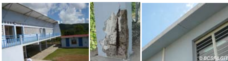
Fig. V-184 : Le Diamant - Ecole du Morne Blanc, décollage de béton, fissure dans la dalle du toit.
