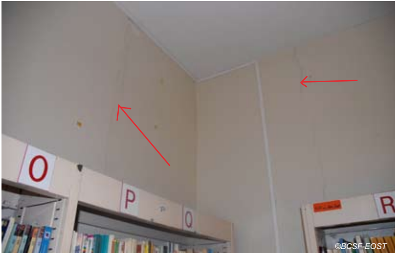
Fig. V-132 : Fort-de-France - Bibliothèque Schoelcher, fissures fines (partie récente).
