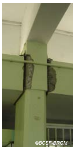
Fig. V-145 : Le François - Ecole Anne Marc, éclatement de mortier suite à l'entrechoquement du pilier du bâtiment principal avec la dalle du bâtiment accolé.
