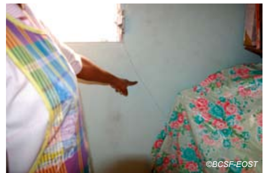
Fig. V-9 : Grand-Rivière, fissure fine en angle de fenêtre (vulnérabilité B, dégâts de niveau 1).
