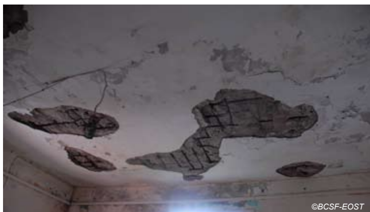
Fig. V-120 : Schoelcher, délitement du béton de couverture suite à infiltration.
