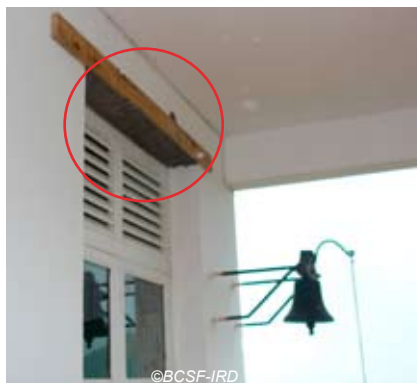
Fig. V-98 : Ecole de Morne Vert, dommage sur linteau (en cours de réparation)
