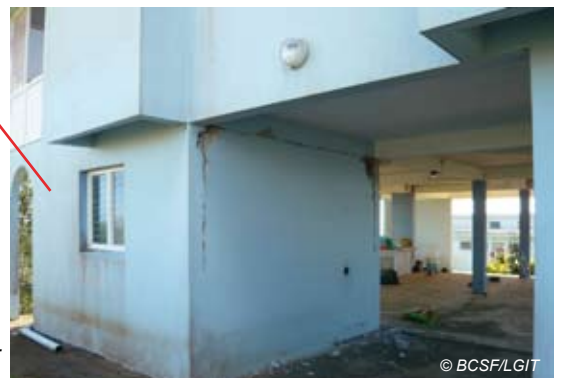
Fig. V-220 : Sainte-Luce - maison individuelle - fissure entre ossature et remplissage.
