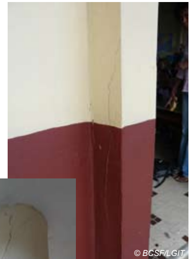
Fig. V-179 : Anses d'Arlet - Ecole Lucea - fissuration dans un poteau peut-être liée à du décollement préexistant du béton.
