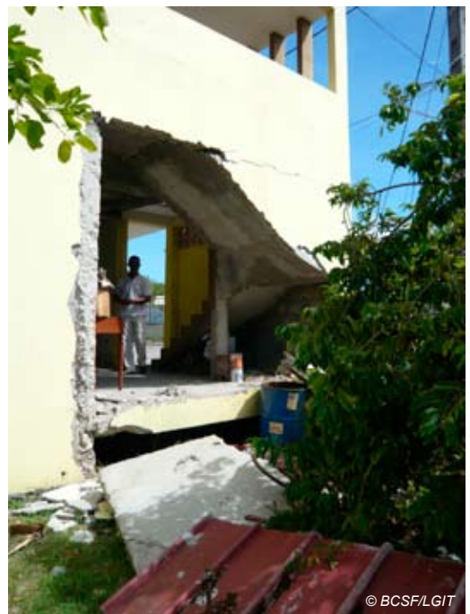
Fig. V 224 : Ferré, Sainte-Anne. La partie avale de la maison a commencé à glisser dans la pente.
