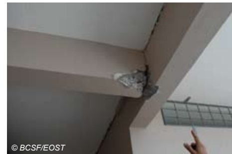
Fig. V-172 : Rivière-Salée - Ecole primaire - dégâts sur partie structurale.
