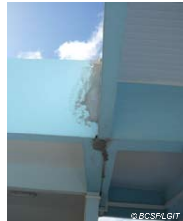
Fig. V-169 : Le Vauclin - Ecole primaire - entrechoquement des deux ailes.
