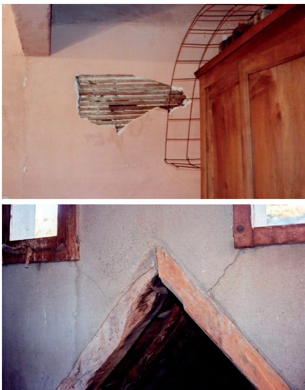
Fig. 19 - Détails des dégâts sur les églises d'Artalens-Souin (6 km de l'épicentre)
