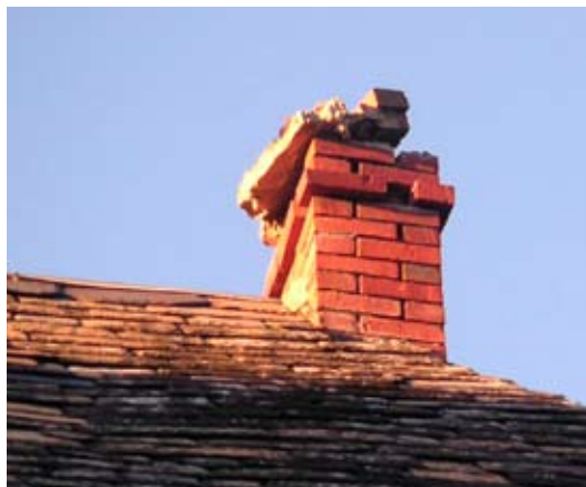
Fig. 23 - Chapeaux de cheminées fragilisés à Arrayou-Lahitte (8,5 km de l'épicentre) - photos DDE65
