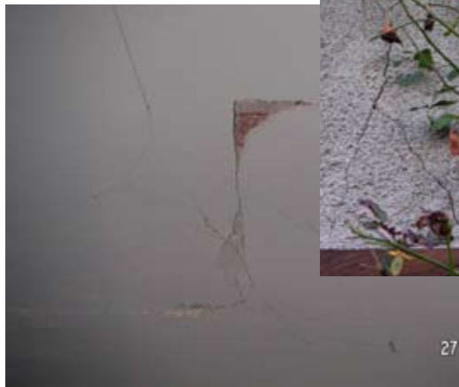
Fig. 24 - Diverses fissures sur murs intérieurs et extérieurs à Arrayou-Lahitte (8,5 km de l'épicentre) - photos DDE65
