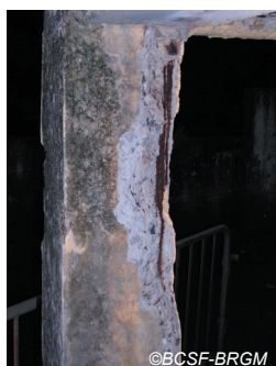
Fig. IV-95. Seul dommage qui nous a été montré sur la commune de Goyave. Il s'agit de l'éclatement du béton d'un poteau de l'école de Christophe, bâtiment ancien et dans un mauvais état de conservation.
