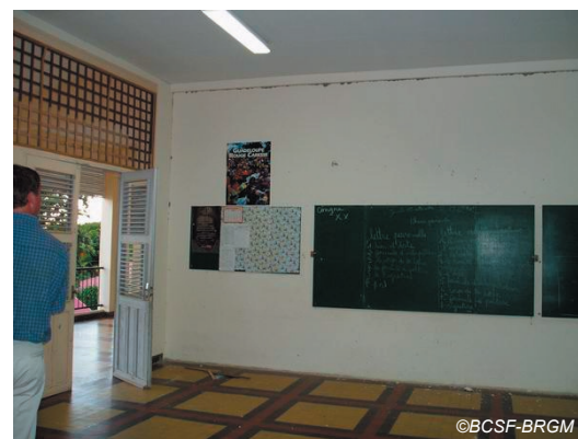
Fig. IV-35. Ecole de Routhiers: les cloisons internes construites pour subdiviser une grande salle au 1 er étage ont toutes été désolidarisées de la structure en béton armé du bâtiment (dommage de niveau 2).
