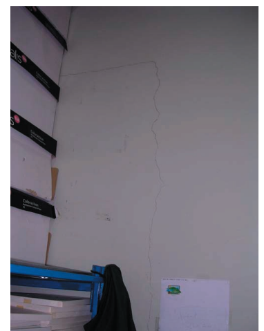
Fig. IV-70. Petit-Bourg - mairie, fissures légères dans la structure non porteuse, salle de reprographie.
