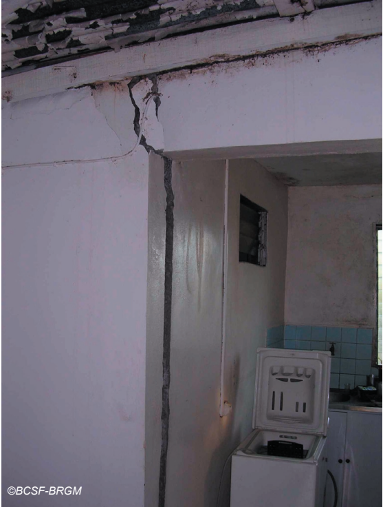
Fig. IV-52. Désolidarisation d'un mur, dommages de niveau 3 et 4 sur une maison en bord de ravine.
