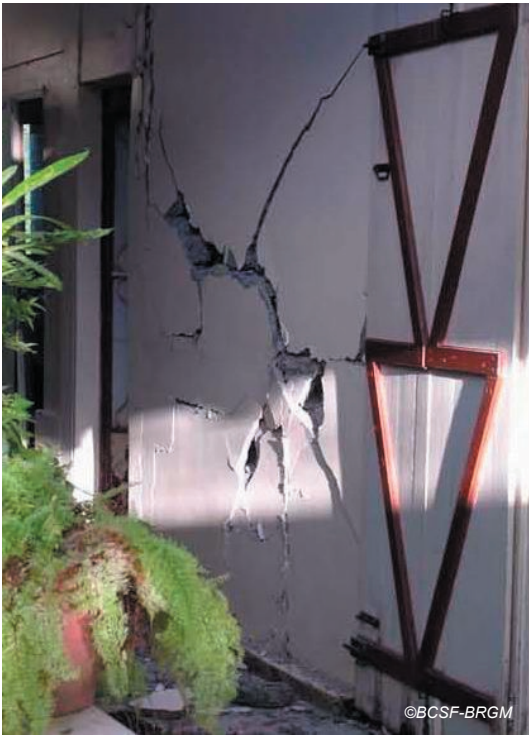
Fig. IV-51. Lieu dit La Plaine. Dommages graves sur une maison individuelle en bordure de la ravine.
