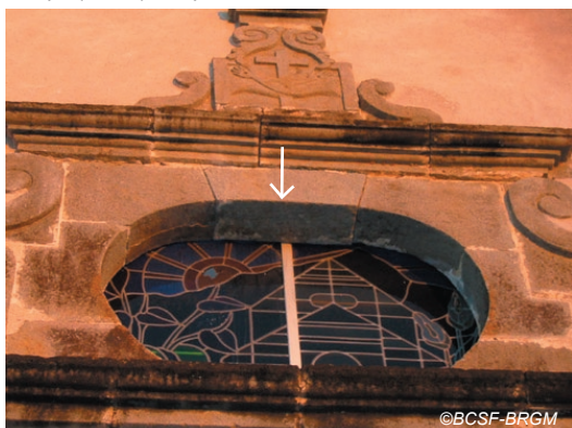
Fig. IV-77. Descente de la clef-de voûte de l'église Saint-Joseph (18e s.) aux puissants contreforts.
