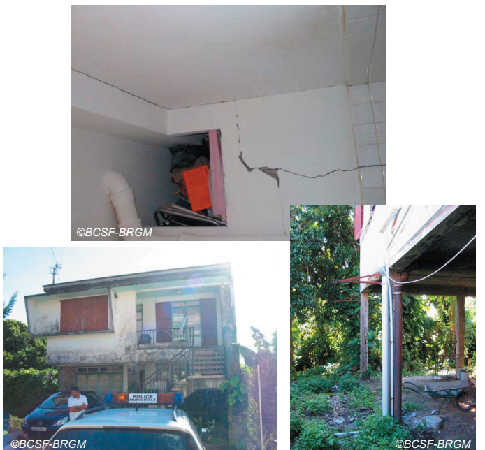
Fig. IV-48. Saint-Claude - maison individuelle sur pilotis, dégâts de niveau 2 et 3, vulnérabilité B.
