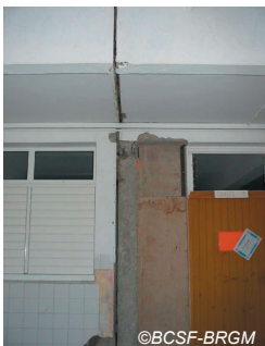
Fig. IV-38. Dégâts suite à l'entrechoquement des corps de bâtiment à l'école mixte du bourg.
