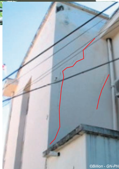
Fig. IV-83. Pointe-Noire façade N-O de l'annexe de la mairie, fissures verticales suite à l'oscillation du bâtiment (dégâts structuraux légers de niveau 2)
