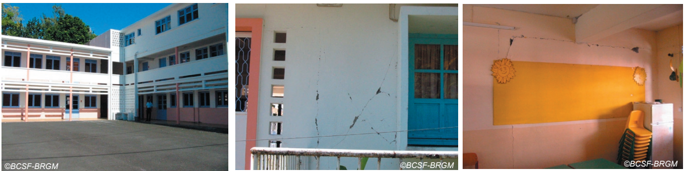
Fig. IV-46. Ecole mixte Louis Chalcol - Entreoquement des corps de bâtiment disposés en L, dégâts de niveau 2 et 3 - vulnérabilité C).
