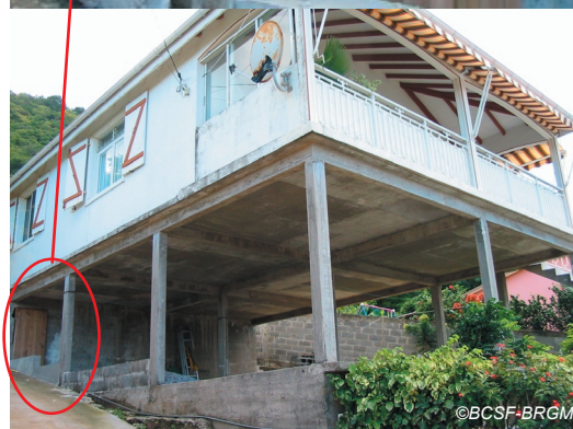
Fig. IV-3 Exemple d'une construction vulnérable implantée sur un terrain en pente et comportant un niveau transparent - Terre-de-Haut.
