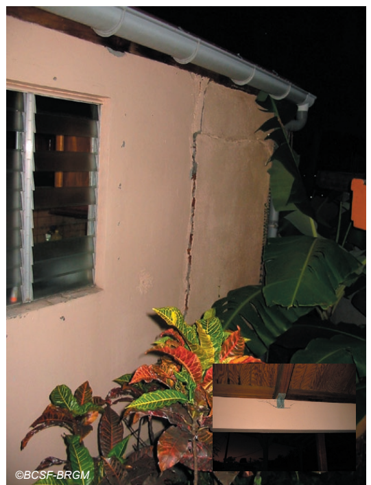
Fig. IV-72. Bouillante - quartier Courbaril - affaissement du terrain et large fissuration.
