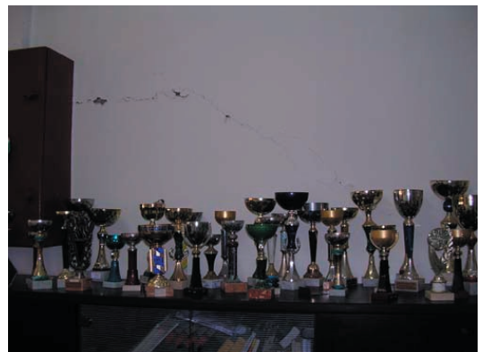
Fig. IV-67. Petit-Bourg - fissure sur un mur non porteur. Sur l'ensemble des coupes, seules 3-4 ont été renversées par le séisme.
