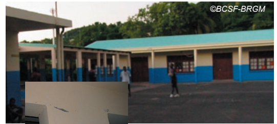
Fig. IV-71. Bouillante - école mixte du Bourg - fissuration sur les piliers du préau (degré 1).
