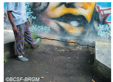
Fig. IV-90. Fissuration large en bout de bâtiment sur les structures porteuses - HLM Henri IV.
