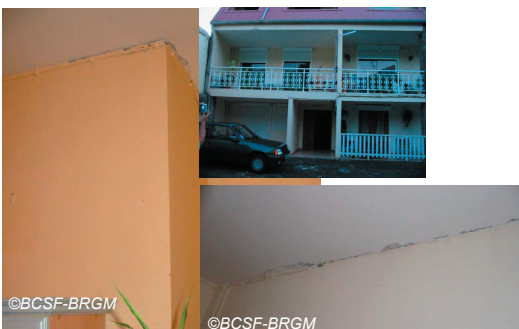
Fig. IV-39. Fissures aux raccords murs-planchers (niveau 2) - dégâts structuraux légers, mais généralisés sur l'ensemble du bâtiment (quartier Dolé).
