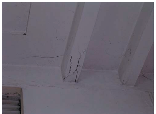
Fig. IV-69. Petit-Bourg - église, fissure sur structure
