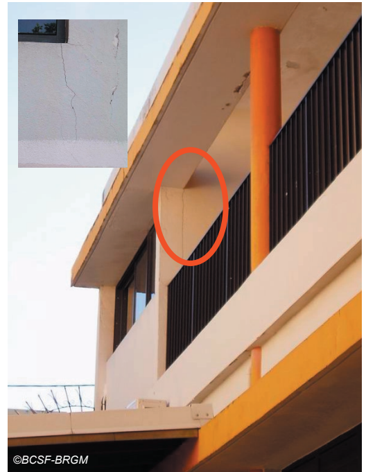
Fig. IV-92. Mairie : dommages légers sur un bâtiment rajouté en 1972 (dommage de niveau 2 ponctuel).
