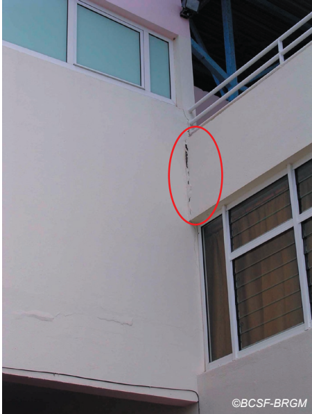
Fig. IV-12. Fissures au collège de Terre-de-Bas. Bâtiment récent, construit selon les normes PS69 (vulnérabilité E).
